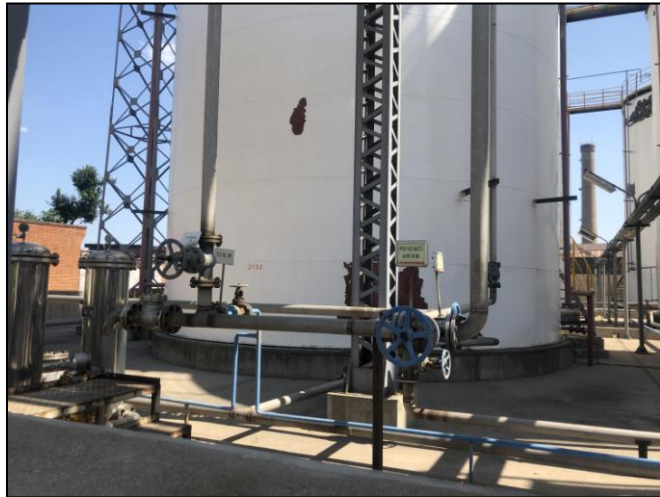
照片 15 乙二醇在用储罐
